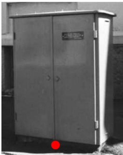
Figuren viser et eksempel på kabinettsskap som kan inneholde drivstoffpumpe og slange for påfylling av drivstoff for fly.
